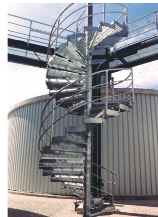
Außentreppe aus Edelstahl
