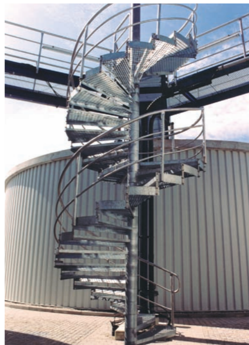
Außentreppe aus Edelstahl
